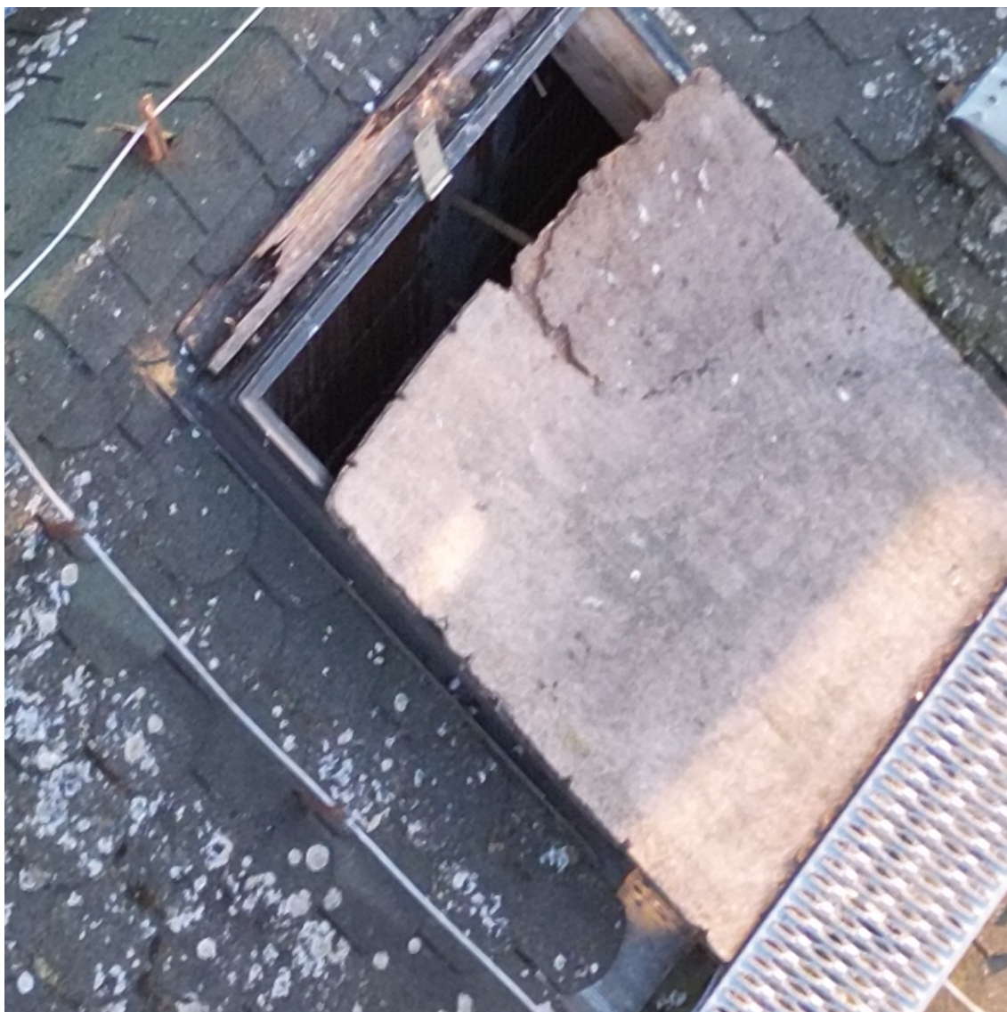
Fot. 08. Prostokątny otwór z płytą częściowo nad lub obok niego; stan wymaga pilnej weryfikacji.
