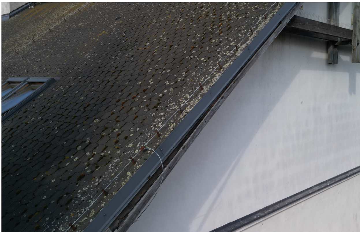
Fot. 01. Rozległe naloty, skupiska przypominające mech, widoczne przewody/linki i zwiędnięte drewno.
