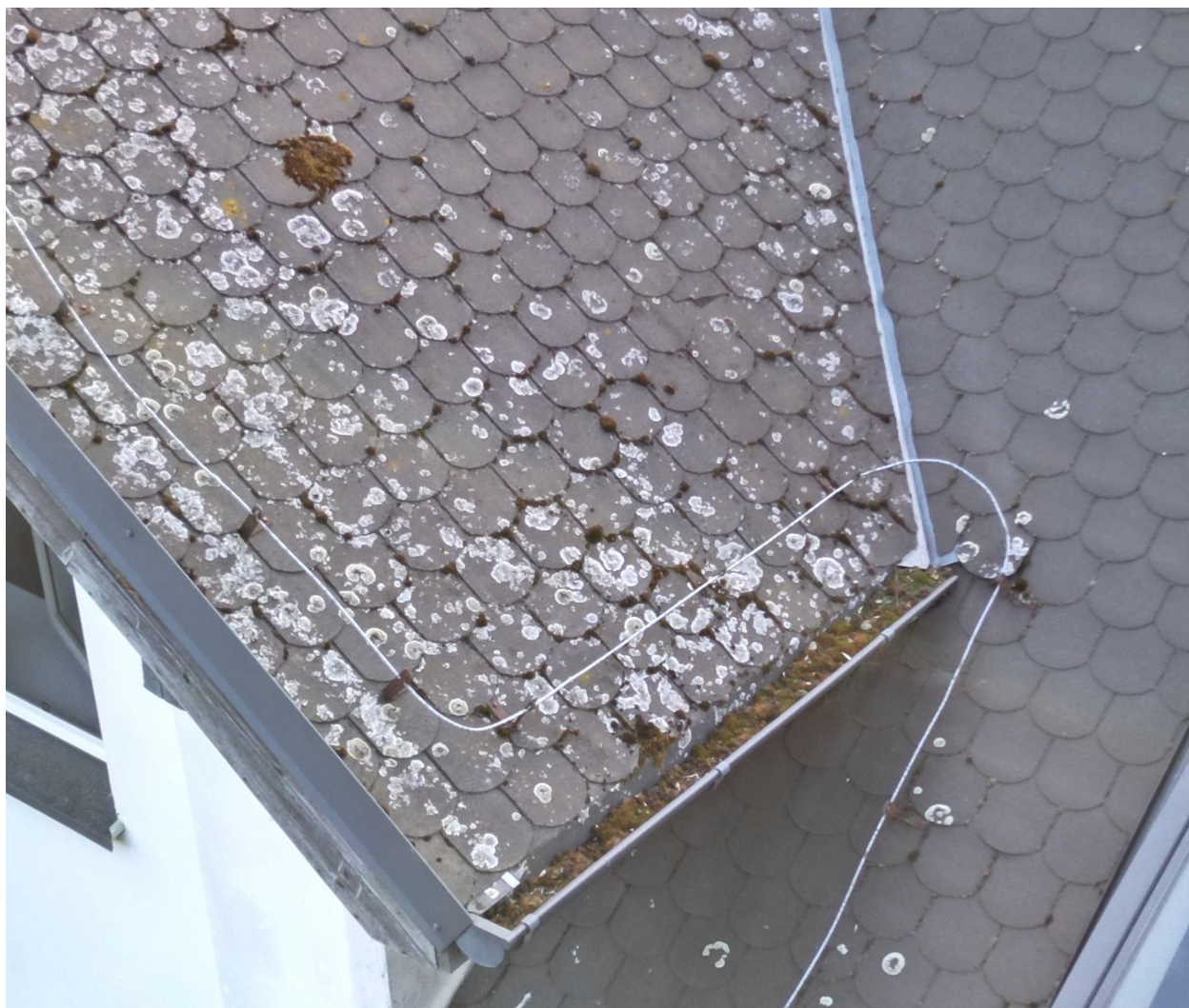
Fot. 02. Materiał organiczny przy połączeniu połaci oraz przewód lub linka o nieustalonej funkcji.
