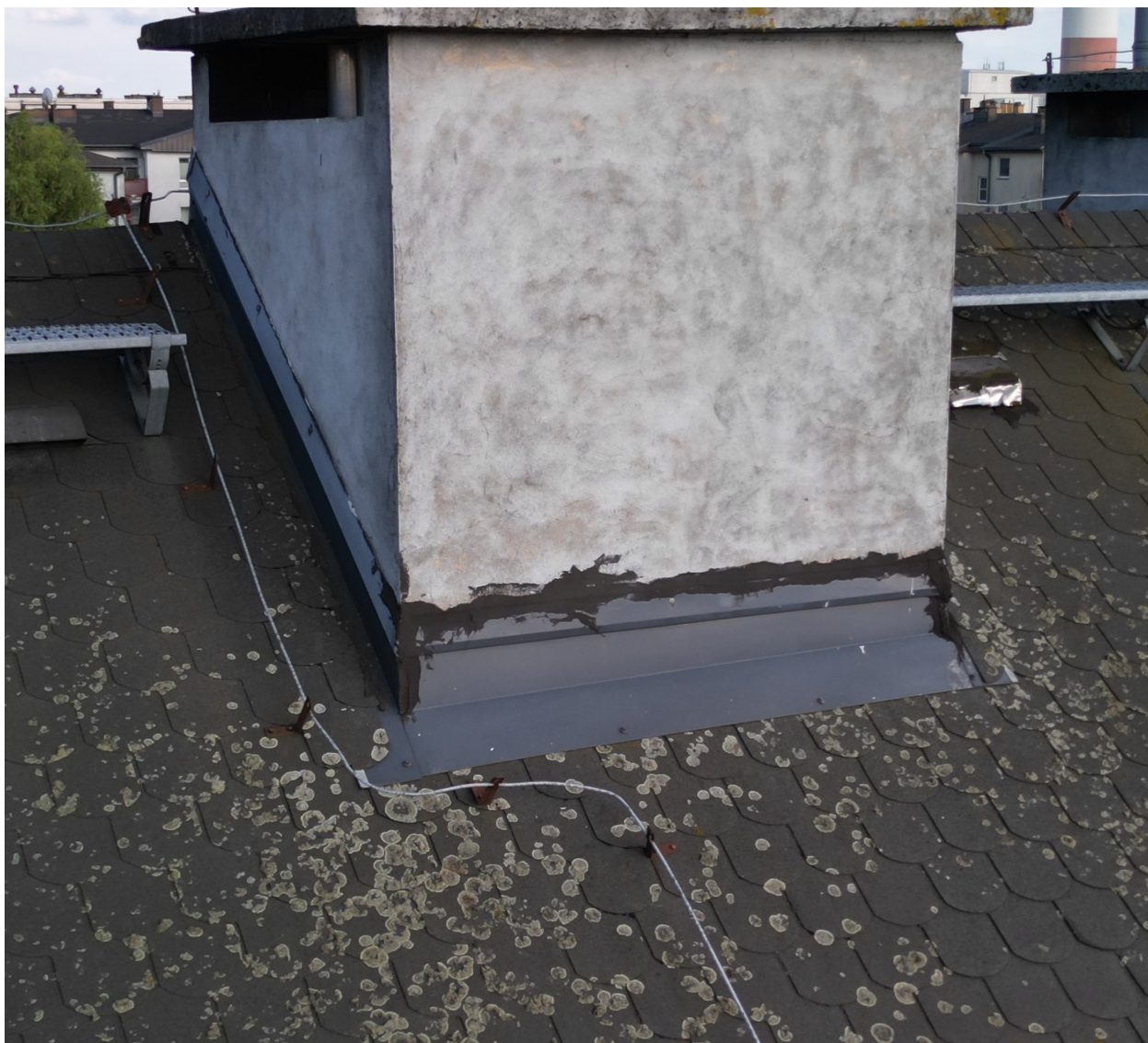
Fot. 03. Widoczny pas materiału naprawczego lub uszczelniającego przy podstawie komina oraz naloty na pokryciu.
