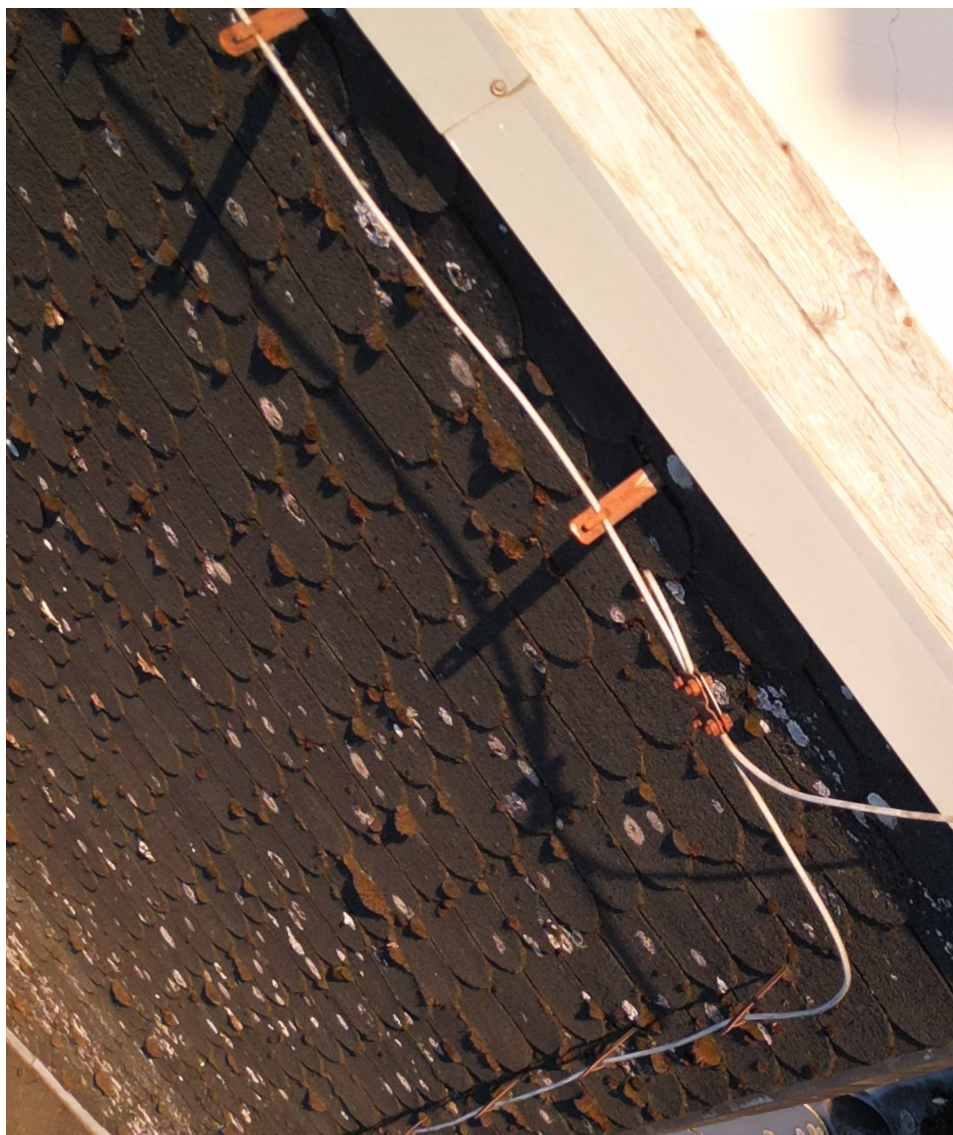
Fot. 09. Materiał zalegający w rynnie oraz przewody prowadzone w rejonie okapu.
