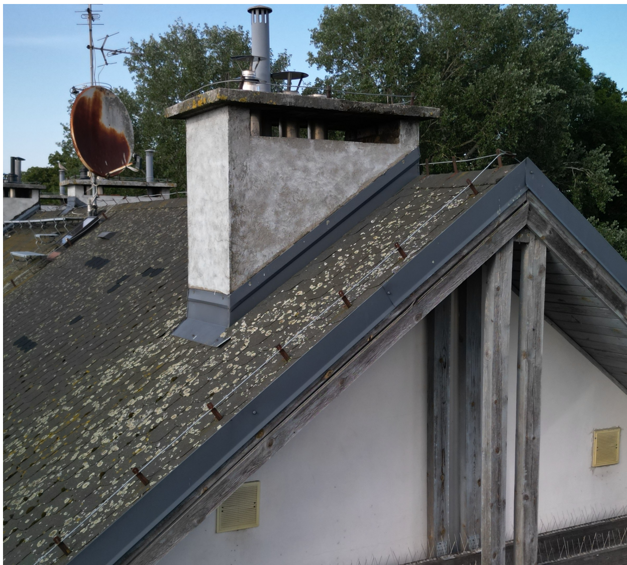
Fot. 04. Rozległa korozja jednej czasy, naloty na pokryciu i czapach kominowych oraz zwiędnięte drewno.
