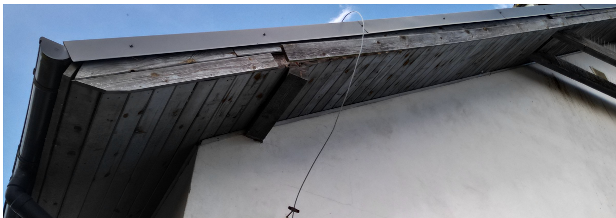
Fot. 05. Miejscowa nieciężkość deski w strefie okapu oraz luźno prowadzony przewód.
