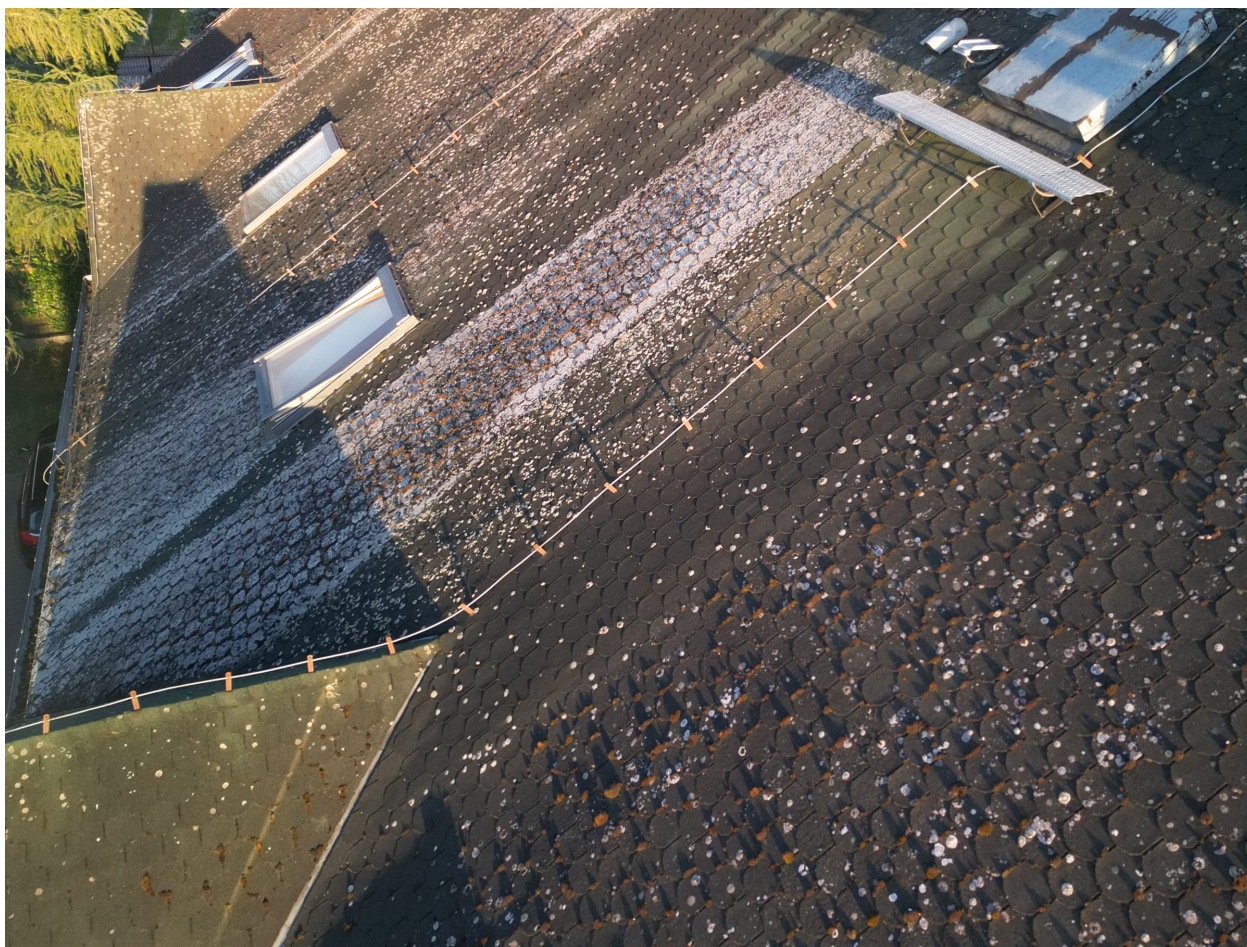
Fot. 07. Rozległe naloty i lokalne różnice wyglądu pokrycia na kilku połaciach.
