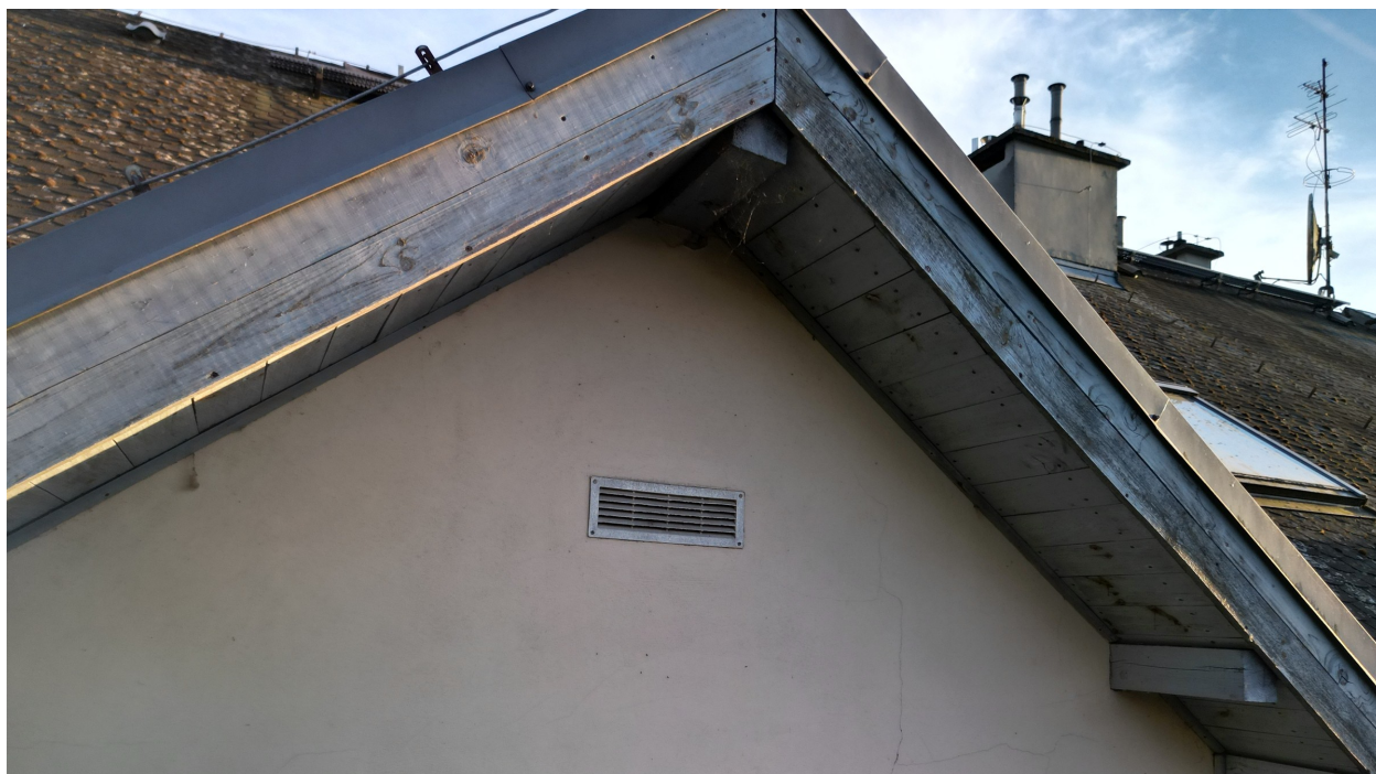
Fot. 06. Cienkie rysy na tynku oraz powierzchniowe zwiótrzenie drewna.
